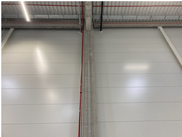
A lentről is látszó csőátvezetések tömítettek
