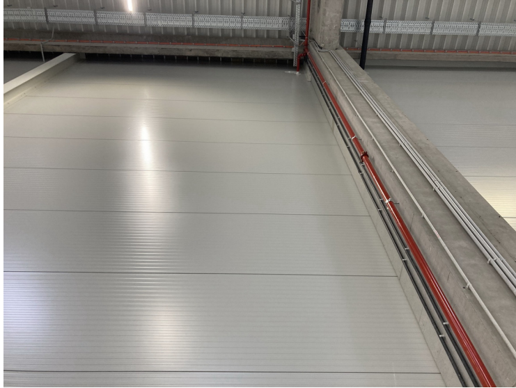
A lentről is látszó csőátvezetések tömítettek
