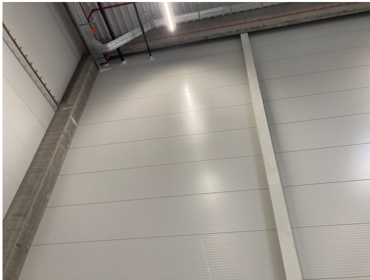
A lentről is látszó csőátvezetések tömítettek
